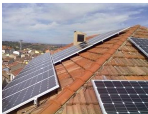
Figura 102: Pannelli fotovoltaici installati sui tetti – Fonte: Comune di Riccia, Riccia. Il borgo del benessere, presentazione powerpoint per gentile concessione del Comune di Riccia.
